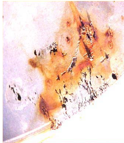
Gambar 3.48. Pelat yang mengalami korosi
