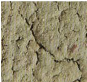
Crazing atau cracking
