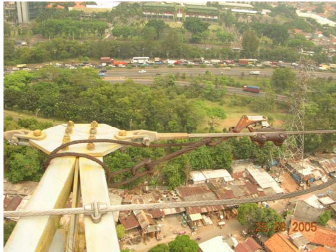
Gambar 10. 4 Kerusakan pada kawat pentanahan
