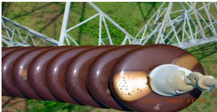
Gambar 10.1 Kerusakan pada Isolator
