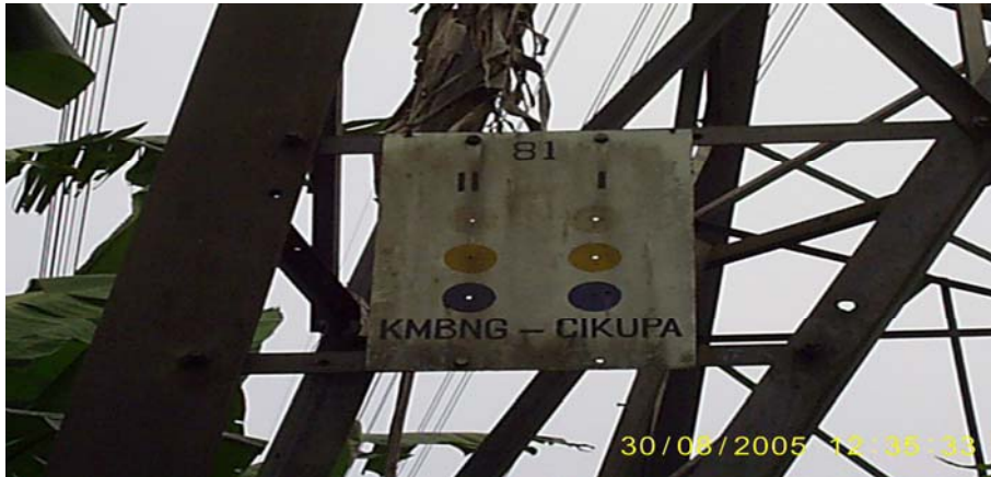
Gambar 10. 2 Kerusakan pada menara
