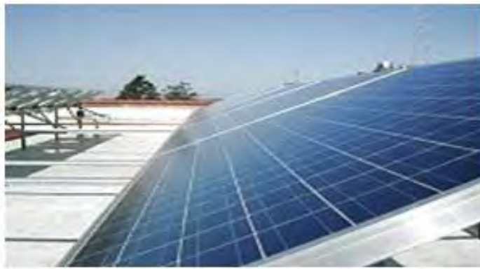
Panel Solar sebagai pembangkit listrik alternatif
