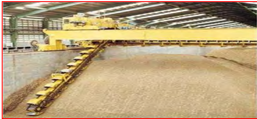
Gambar 10. Timbunan bahan baku dengan alat pengambil menggunakan konveyor bucket ( www.bulk.com )
