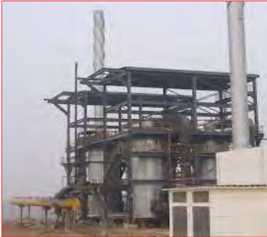
Gambar 29. boiler vrtikal, steam yang dihasilkan untuk pembangkit listrik.
